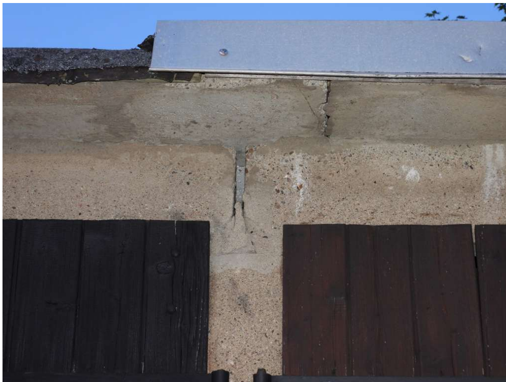
Fuge an Garage – potenzielles Fledermausquartier
